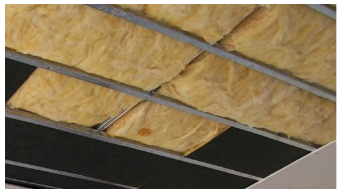
Aislamiento por el interior sobre cielorraso.
